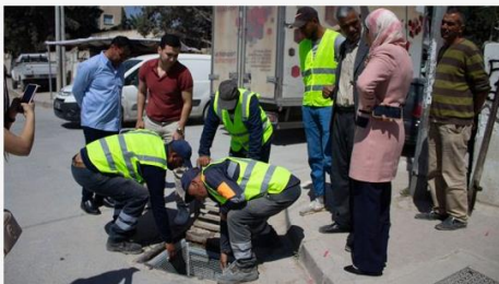
En Tunisie, mise en place d'un filtre dans une bouche d'égout. © DR
